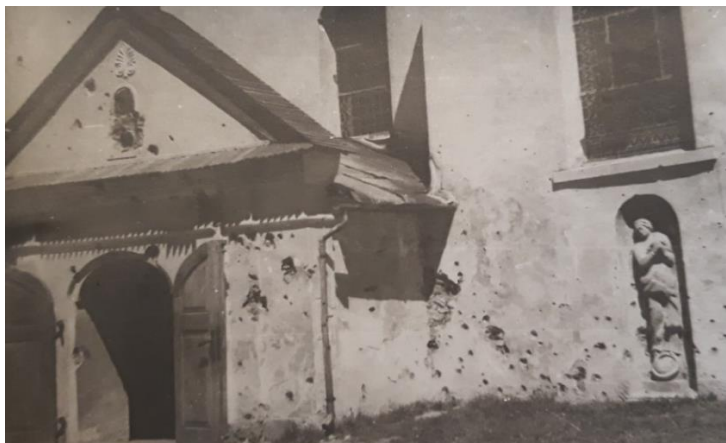
Uszkodzony od wybuchu granatu fragment muru kościoła św. Katarzyny wraz z nowymi witrażami
